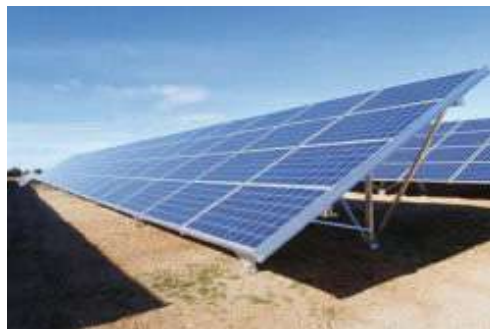
Panneaux photovoltaïques - www.alescevennes.fr
