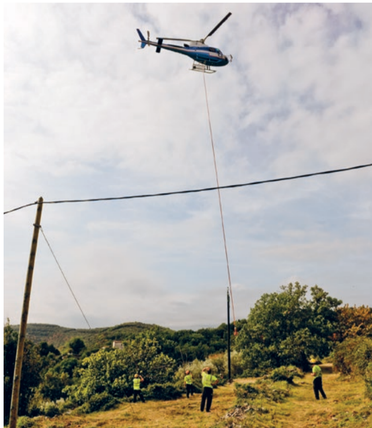
Territoire d'Énergie Gard-SMEG pilote chaque année près de 20 M€ de travaux sur les réseaux électriques du Gard.
