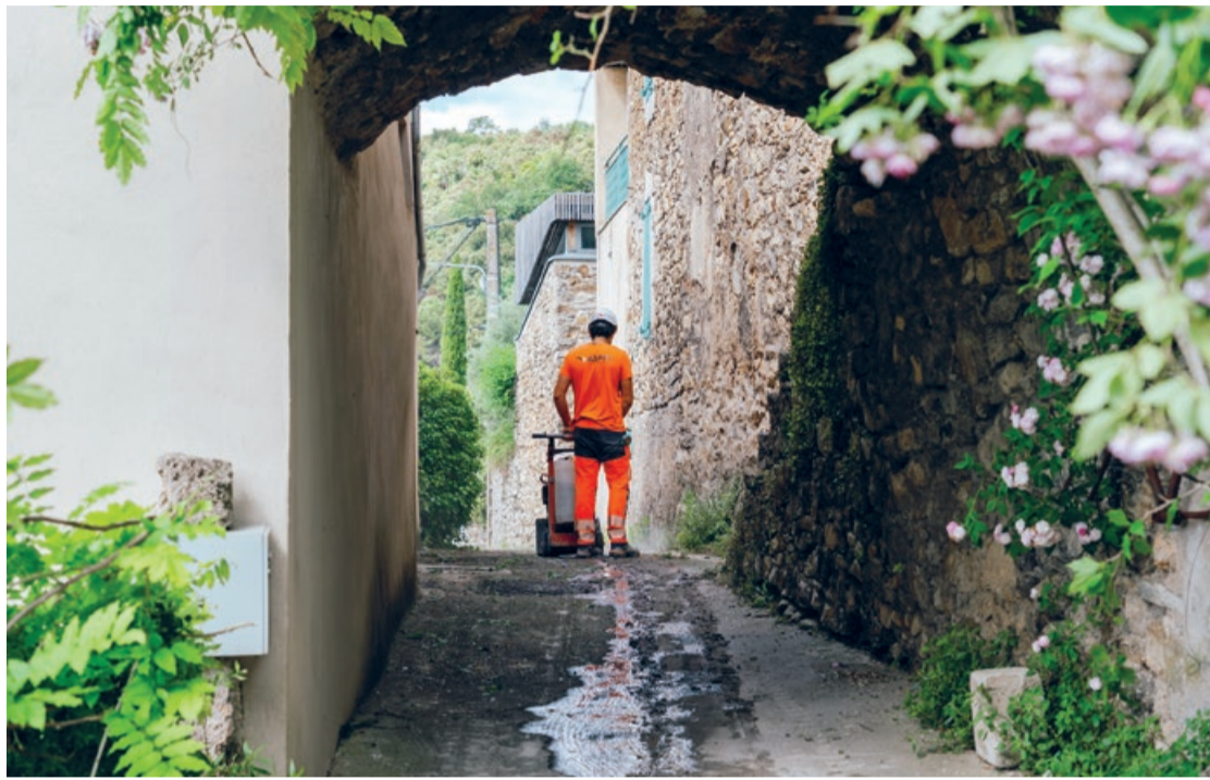
Pour remplacer ces 2,3 km de conduite d'eau potable, les entreprises doivent intervenir sur de nombreuses parcelles privées.
