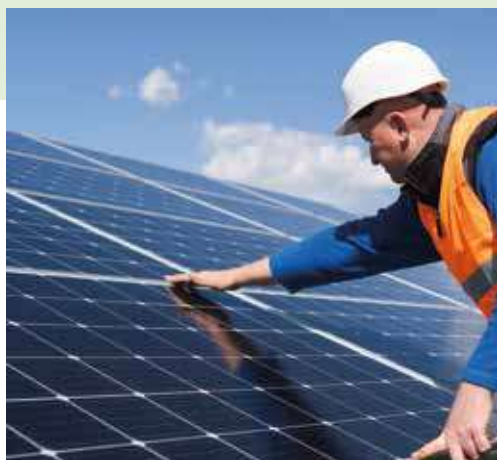
L'installation de panneaux photovoltaïques se démocratise chez les particuliers.
